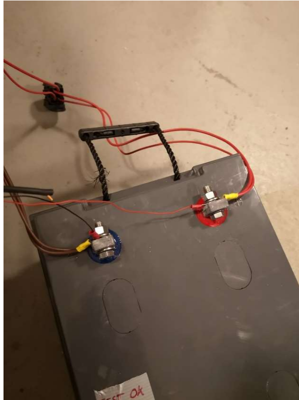
Figura 19 Batería conectada en la pila de combustible y el sistema de monitoreo
