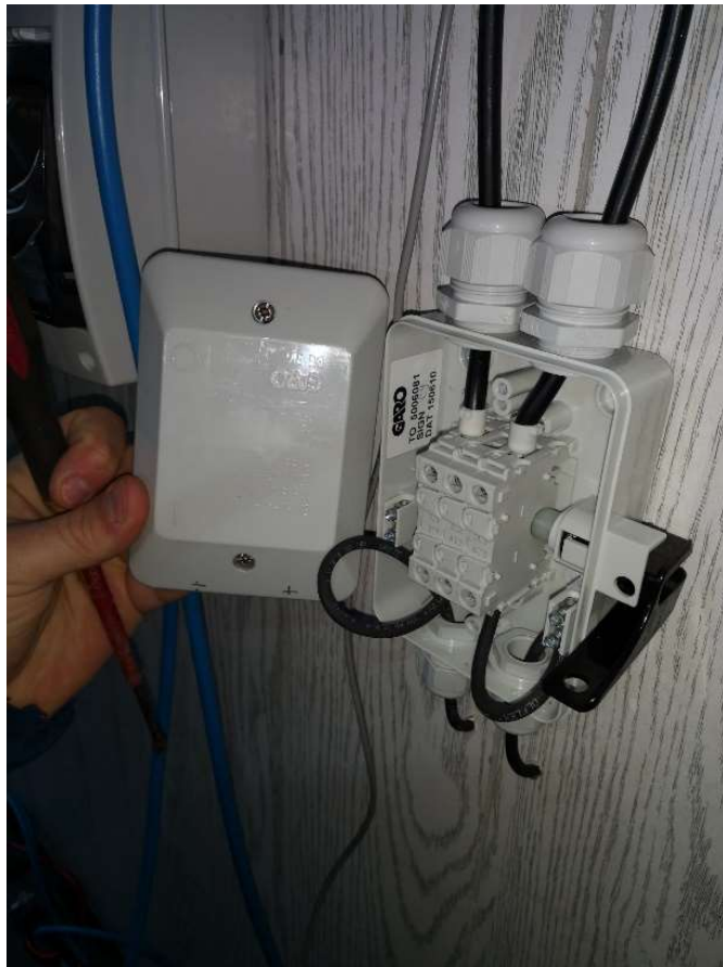
Figura 4 Protecciones de los paneles solares
