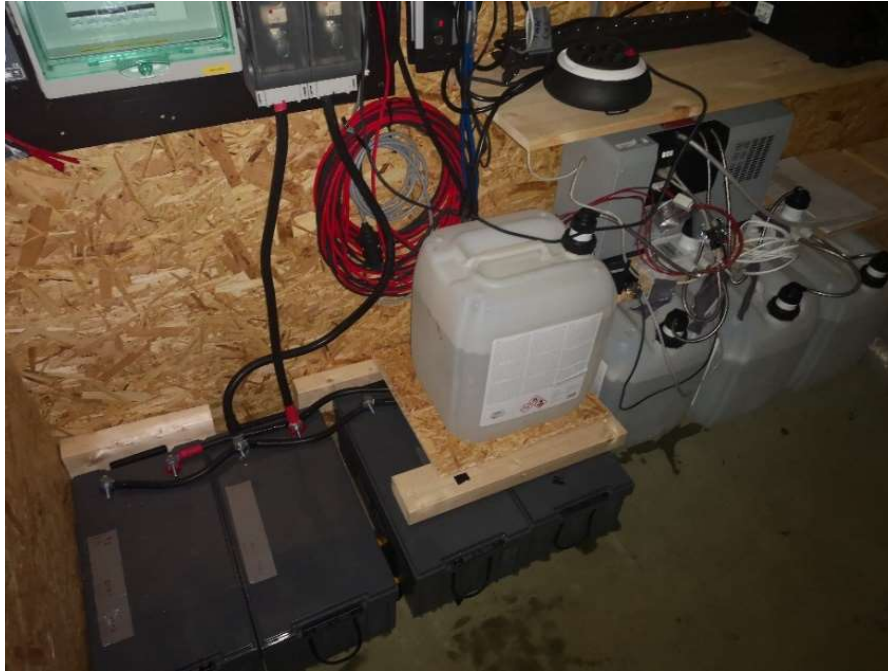
Figura 5.13 Todo el sistema instalado
