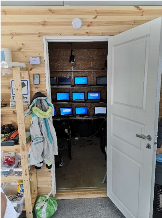
Figura 1.8 Sala de ordenadores y equipos electrónicos
