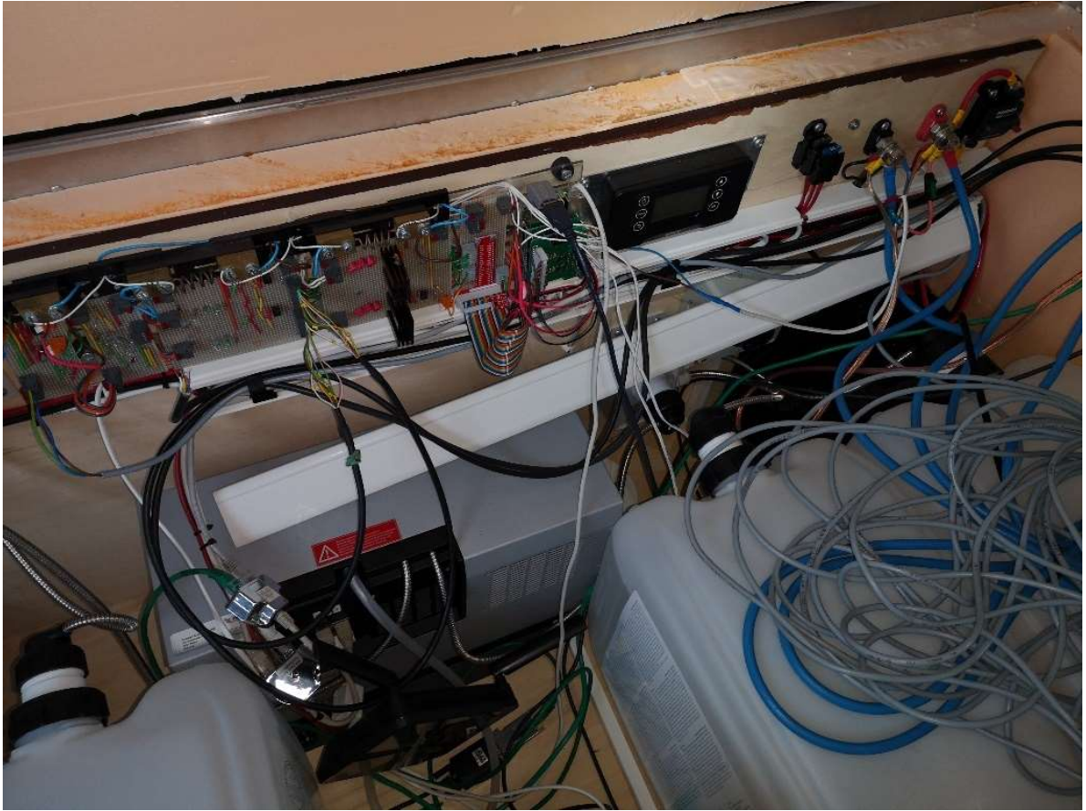
Figura 5 Dentro de la caja de metal, con la pila de combustible, 4 latas de combustible y los cables
