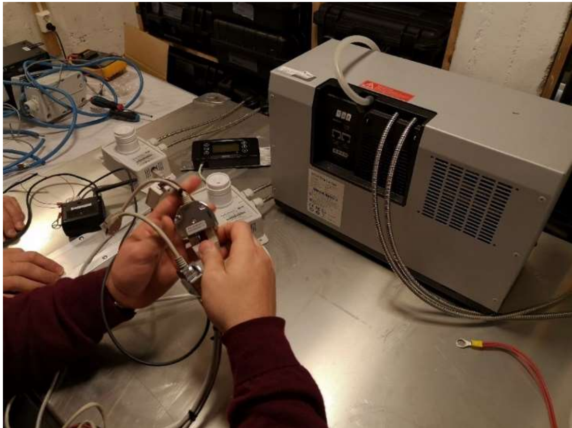
Figura 14 Conexión de los cables para el control de las baterías y la pila de combustible
