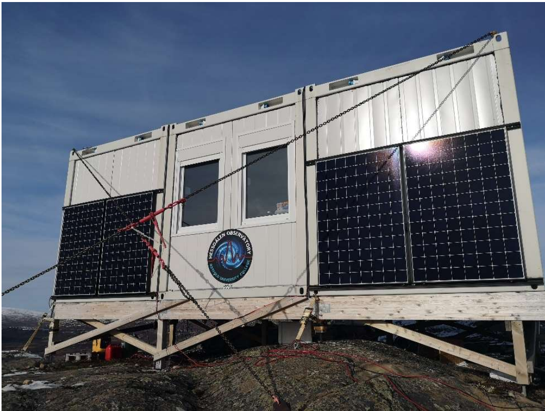
Figure 3.5 Paneles solares instalados en Skarvan (300W cada uno)
