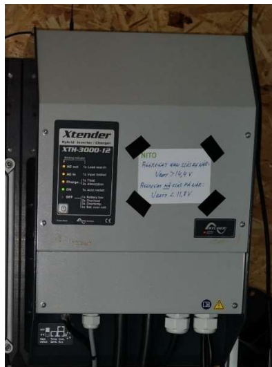
Figura 3.12 Inversor instalado en la base de Skarvan
