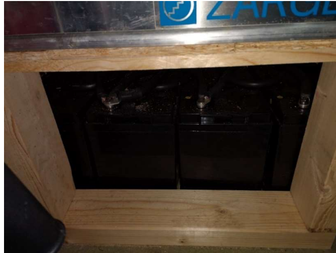
Figura 3.6 Banco de baterías en Skarvan
