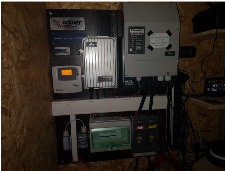
Figura 5.14 El sistema previamente instalado donde conectamos las baterías y la pila de combustible
