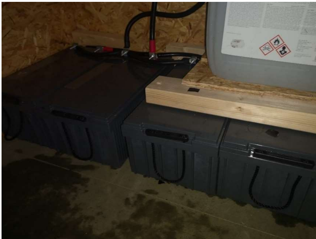
Figura 4 Baterías conectadas en paralelo
