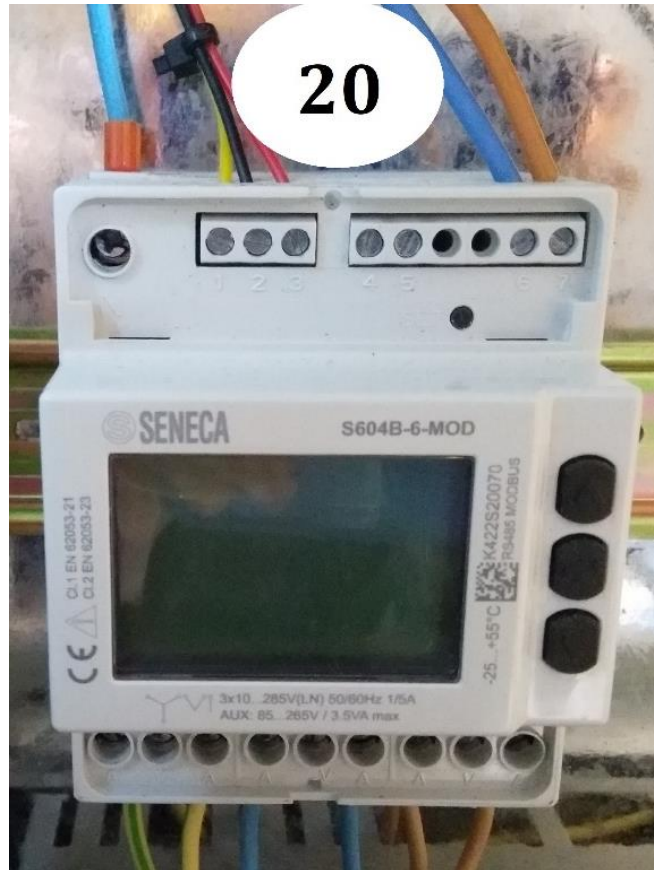
Figura 3.15. Analizador de red de la instalación.
