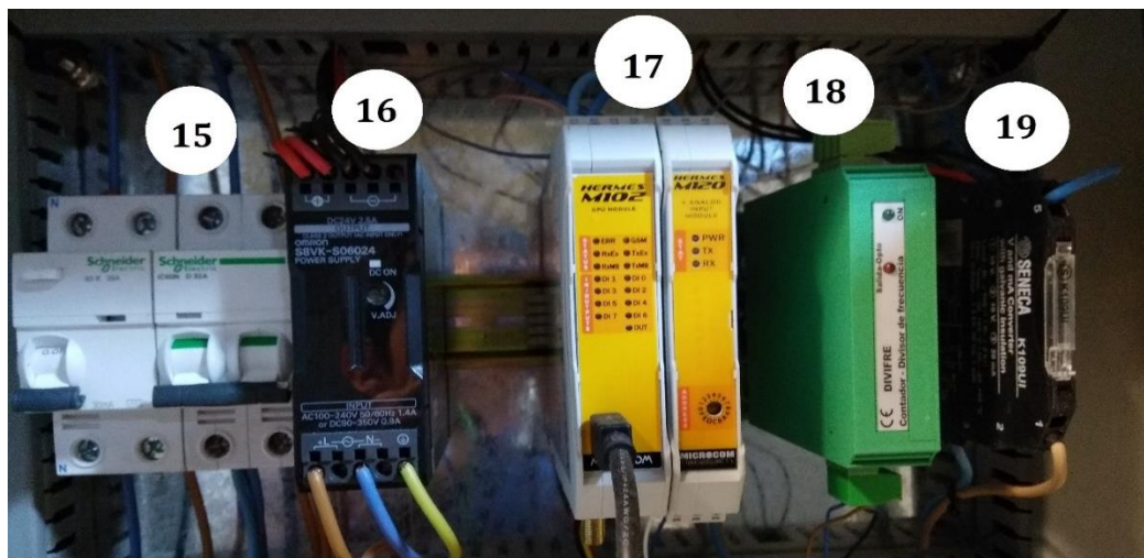
Figura 3.14. Instrumentos electrónicos para el registro de datos y protección de la instalación.
