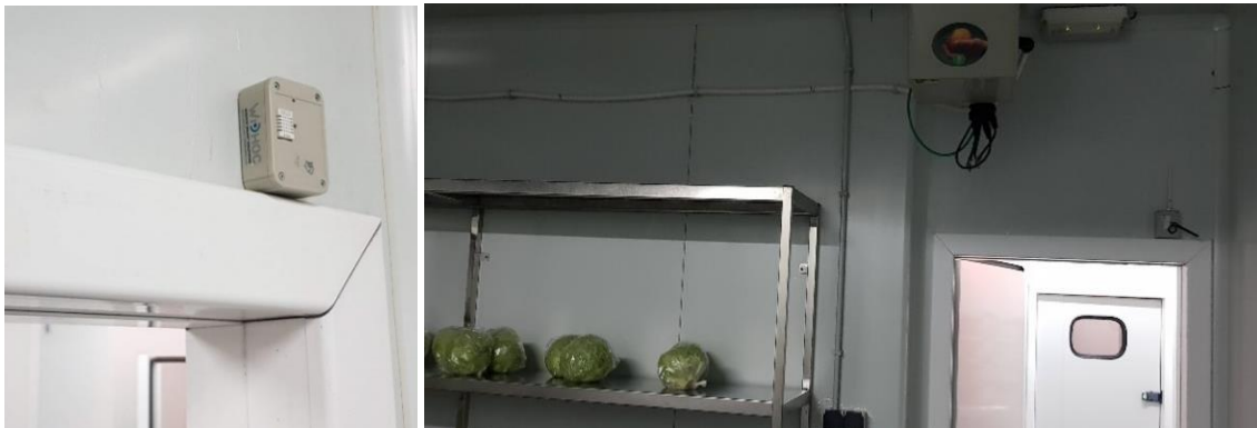
Figura 71. Nodos Gateway y Slave registrando datos en el interior de las cámaras.
