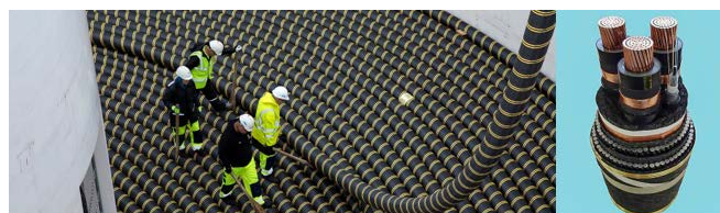
Figura 80. Cables de exportación XLPE (Fuente: Google)
