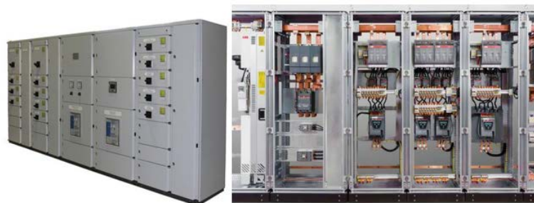
Figura 66. Cuadro eléctrico MV (Fuente: ABB)
