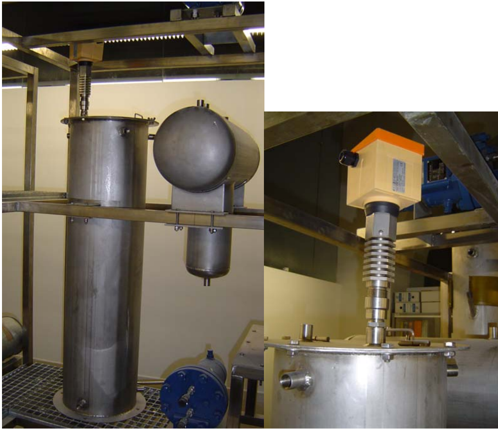
Figura 5. 15- Deposito D-04 y detalle sensor de nivel capacitivo.
