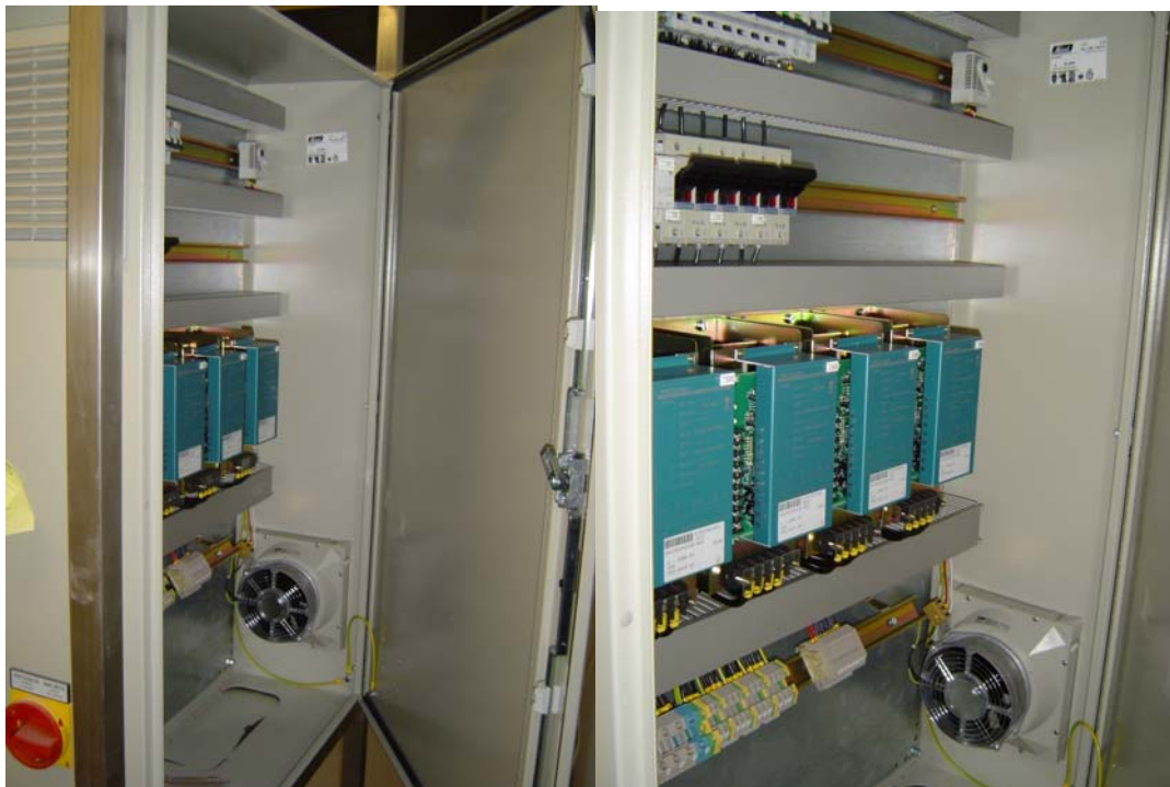
Figura 5. 28- Detalles del interior del armario de control de potencia.
