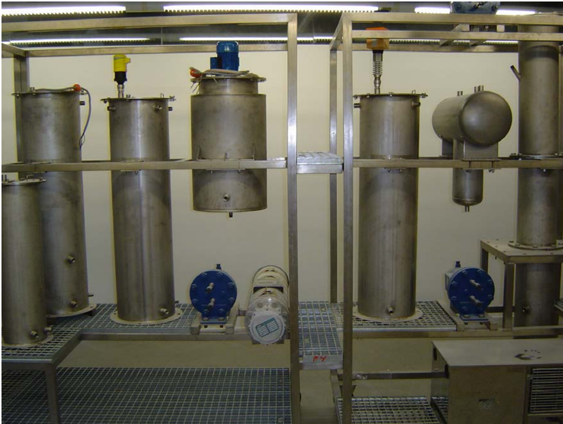
Figura 5. 31- Vista bastidores principales reactor y columna.
