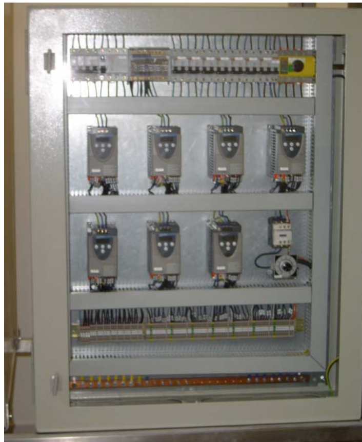
Figura 5. 29- Armario de variadores de velocidad.
