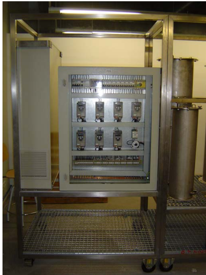
Figura 5. 27- Bastidor elementos eléctricos y de control.
