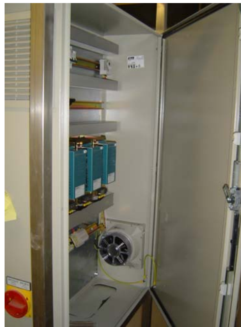
Figura 4. 26-Armario de tiristores
