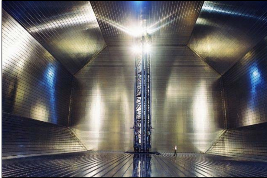
Figura 16. Imagen tanque de membrana LNG
