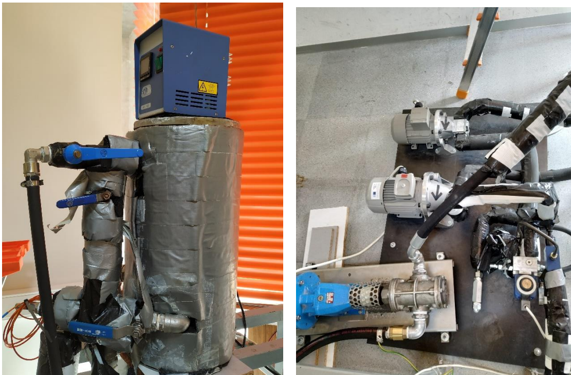
Figura 2. 2.Tanque del circuito principal y sistema de bombeo del circuito primario.
