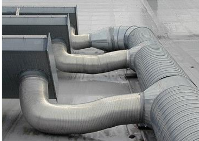
Figura 37. Conducto principal que conduce el aire caliente al secadero.
