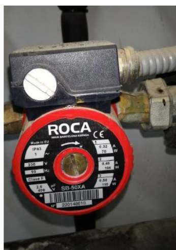
Figura 75. Bomba del sistema ACS
