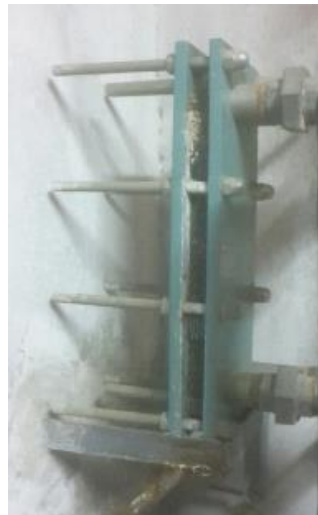
Figura 107. Intercambiador de placas
