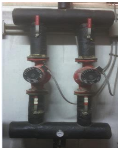
Figura 108. Bomba del sistema ACS
