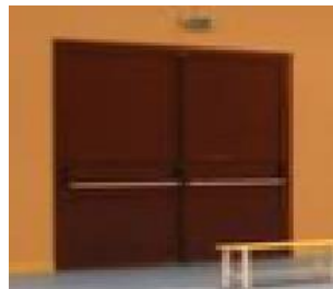
Figura 78. Puerta de emergencia
