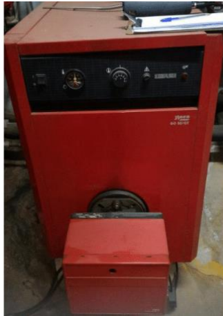
Figura 39. Caldera y quemador ACS
