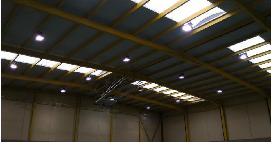
Figura 112. Halogenuros metálicos en pista
