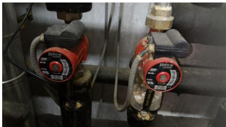
Figura 42. Sistema de bombeo ACS
