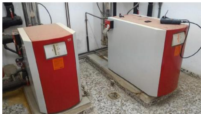
Figura 102. Sala de calderas
