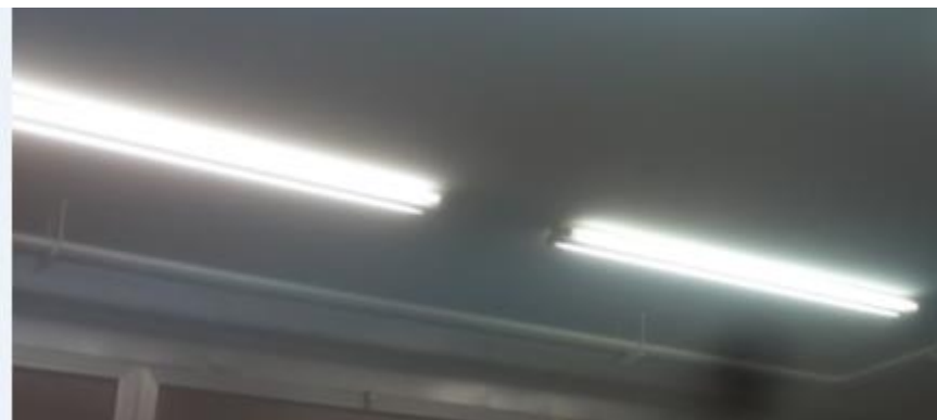
Figura 53. Tubos fluorescentes de la sala de gimnasia
