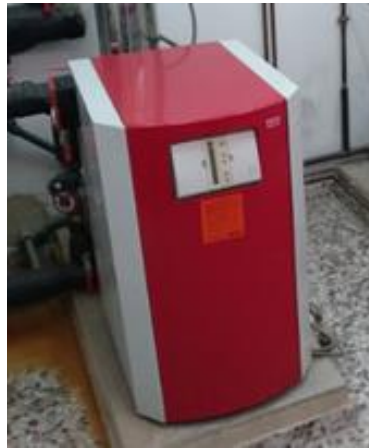
Figura 109. Caldera de calefacción
