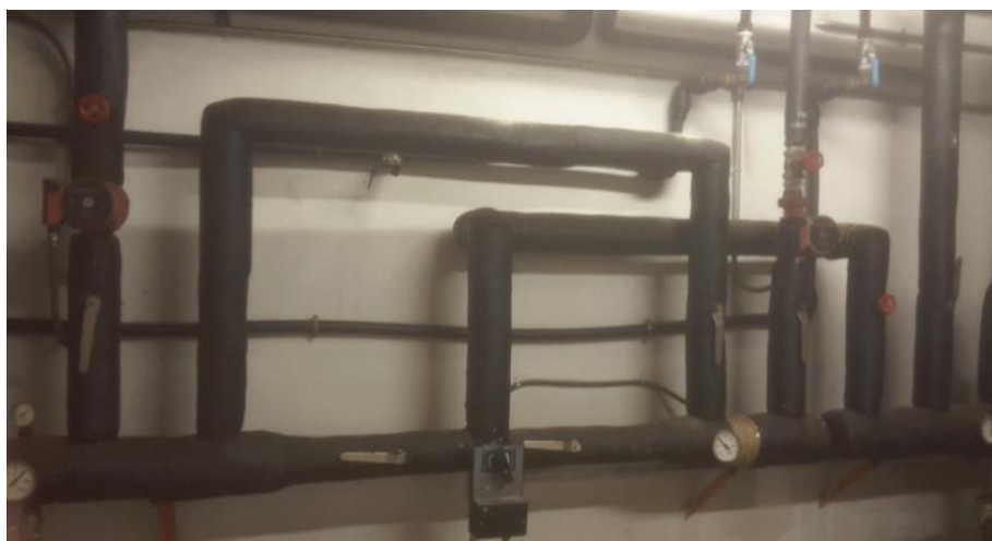
Figura 7. Conjunto de tuberías de los sistemas de calefacción y ACS
