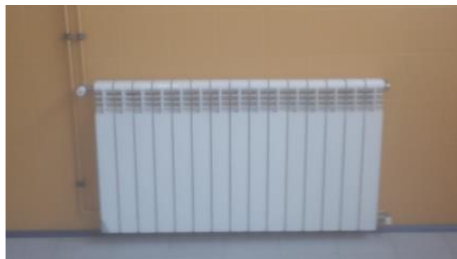
Figura 77. Radiador (15 módulos) de vestuario
