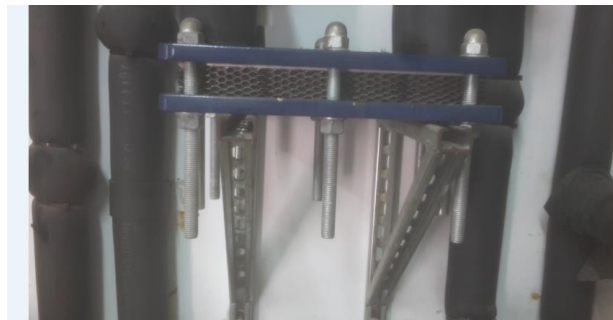
Figura 74. Intercambiador de placas
