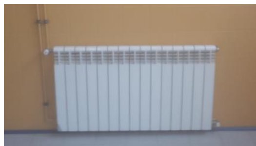
Figura 110. Radiador (15 módulos) de vestuario
