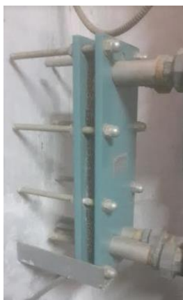
Figura 43. Intercambiador de placas
