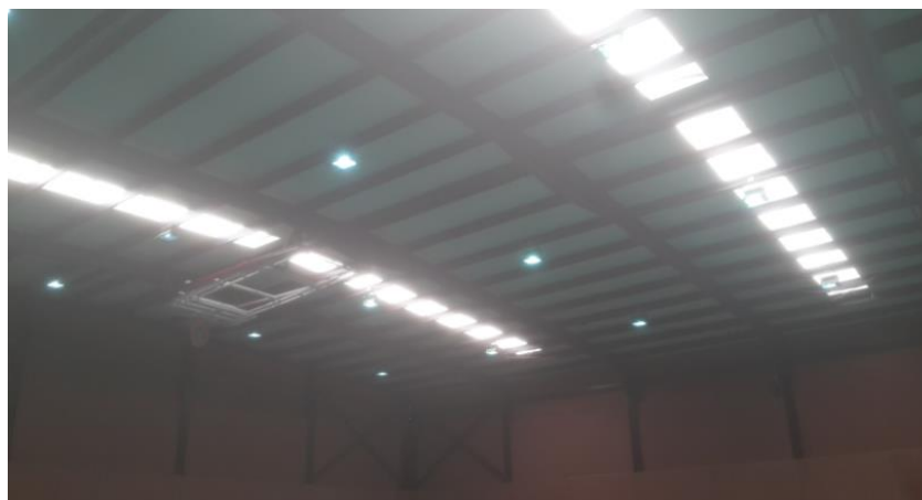
Figura 81. Halogenuros metálicos en pista
