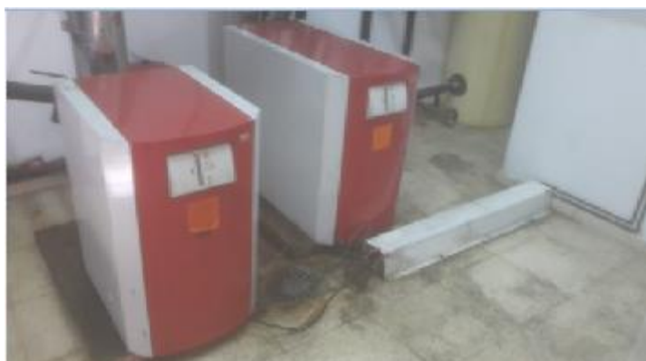
Figura 69. Sala de calderas
