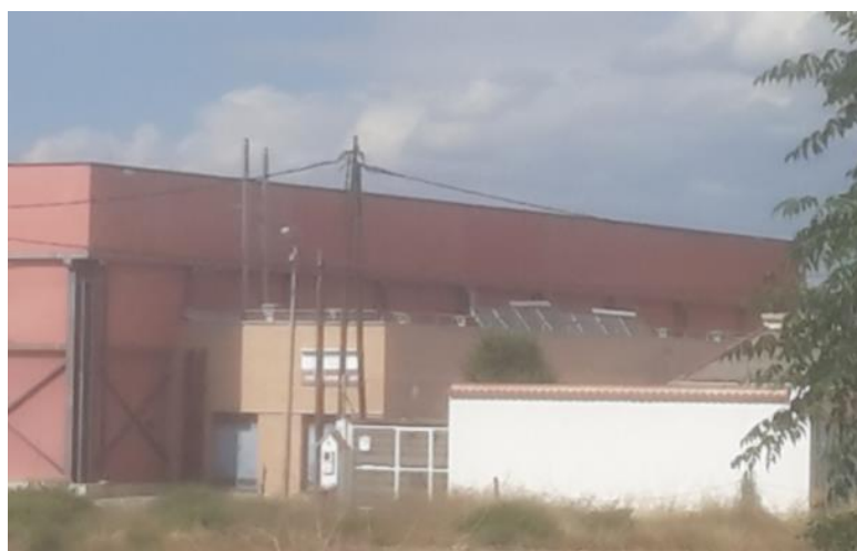
Figura 84. Captadores solares vistos de frente
