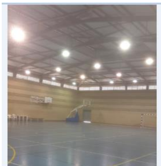
Figura 51. Halogenuros metálicos en pista
