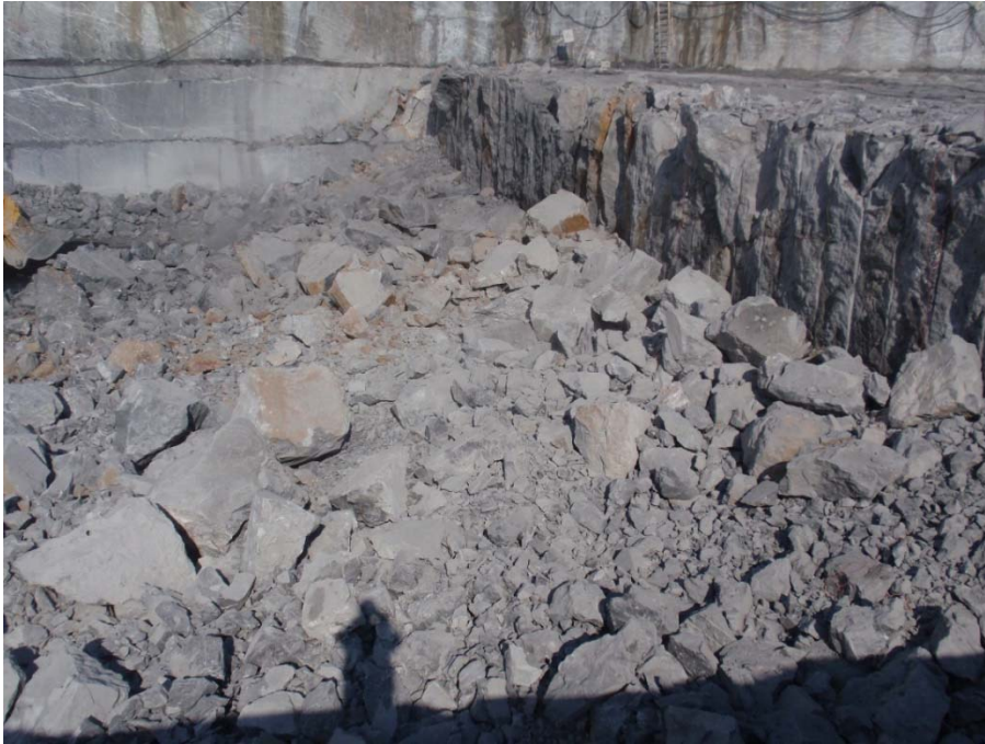
figura 2.8. Voladura con rozado horizontal inferior y precorte vertical en Markina, Guipúzcoa (Trigueros et al, 2011).
