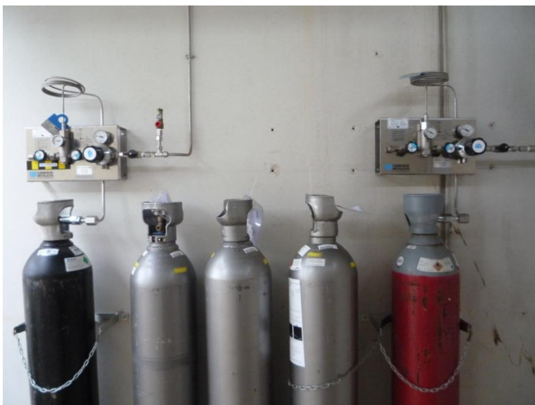
Ilustración 17. Central de suministro de GAS.
