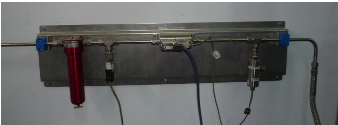
Ilustración16. Rampa de Gas.
