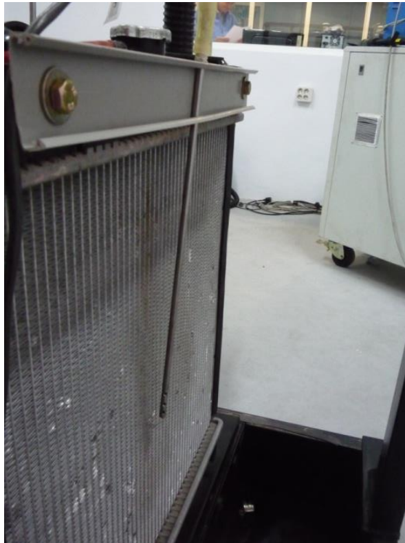
Ilustración 11. Temperatura del Aire a la Salida del Intercambiador.
