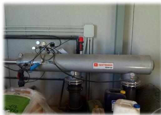
Figura 20. Filtro de malla
