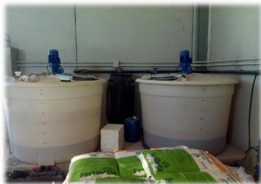
Figura 21. Tanques de abonado
