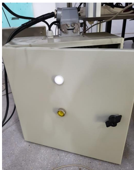
Figura 2.16. Exterior del panel de control
