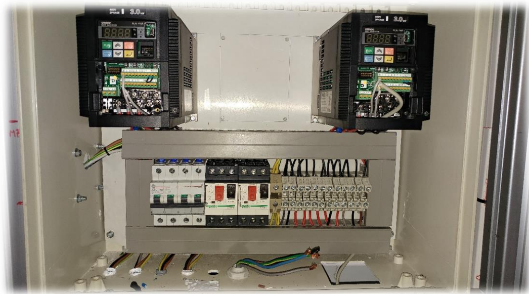
Ilustración 63. Cuadro eléctrico destinado al control de potencia eólico
