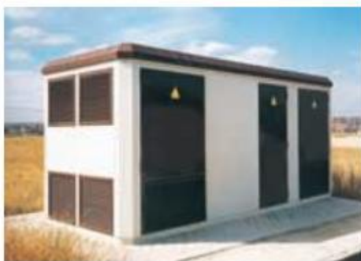
CT prefabricado Ormazábal PFU-5
