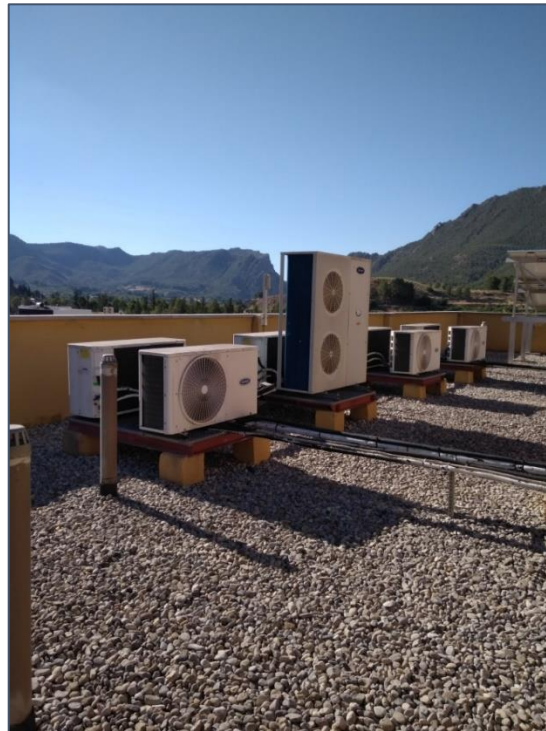
Figura 6. Equipos de climatización del edificio
