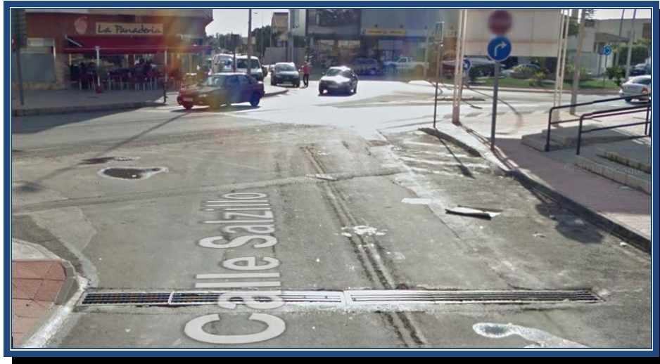
Foto N°11: Rejillas en C/ Salzillo. Punto de Entronque
