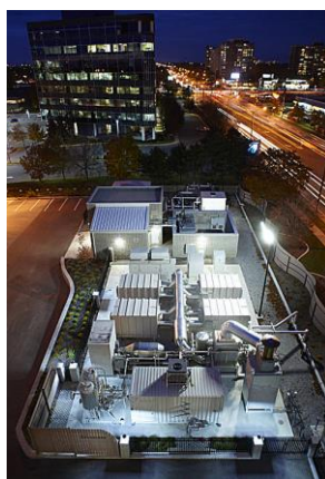
Figura 3.22. Instalación Enbridge III. (Fuente: Enbridge 2009)
