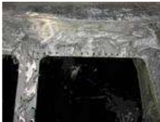
Figura 6. Ejemplo corrosión por exfoliación, Duber, R. [2014].
