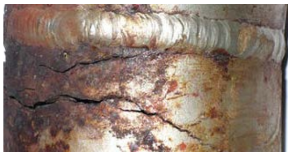
Figura 9. Ejemplo de fractura por corrosión bajo tensión, Labtesa [2.010]
