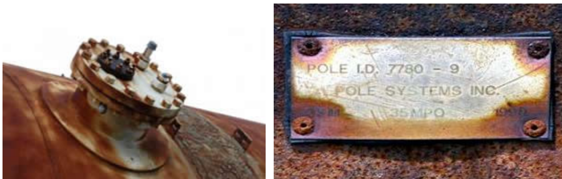
Figura 2. Ejemplo corrosión galvánica, Corrosión en arandelas Belleville [2015] y Todoproductividad [2010]
