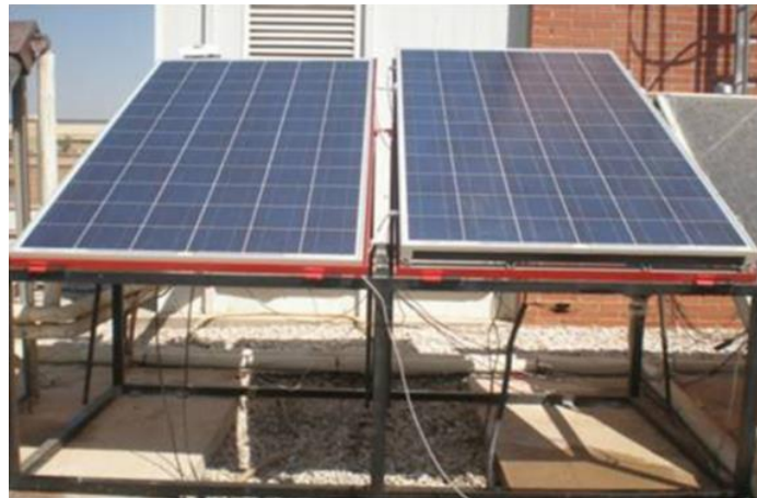
Figura 2.4. Instalación experimental. Panel simple (izquierda), panel con canal de refrigeración (derecha) (Mazón, 2014).
