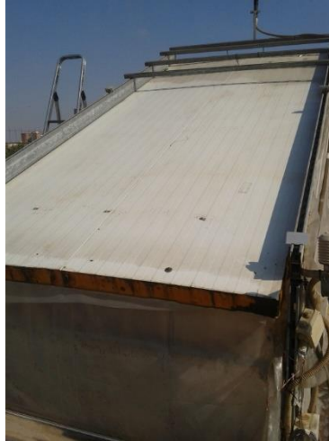
Figura 4.2. Estado inicial de la estructura soporte.
