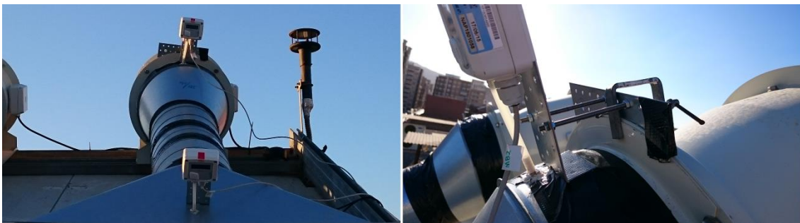
Figura 4.14. Disposición de los sensores de presión en las conducciones metálicas.
