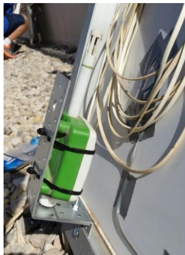
Figura 4.10. Instalación de las sondas de temperatura de aire modelo EE16.
