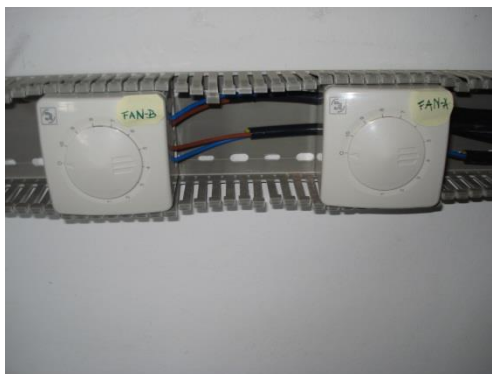
Figura 4.15. Reguladores de velocidad de los ventiladores.
