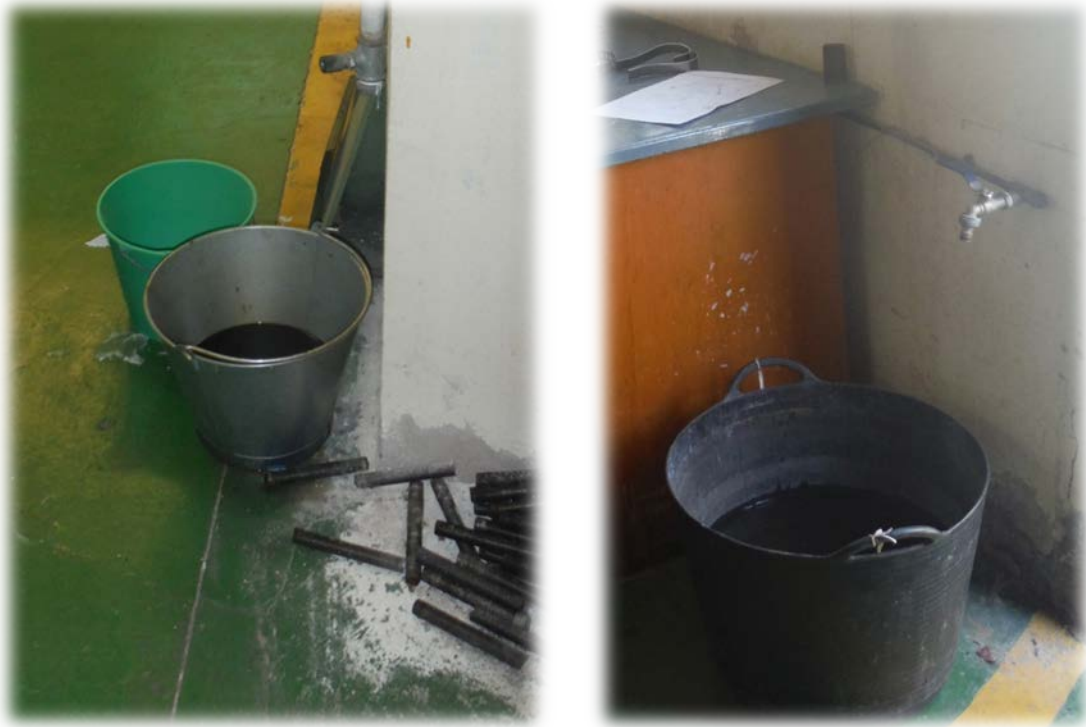
Figura 14. Cubos bajo grifos que gotean en el Taller de Fabricación Mecánica antes de su traslado al ELDI.
