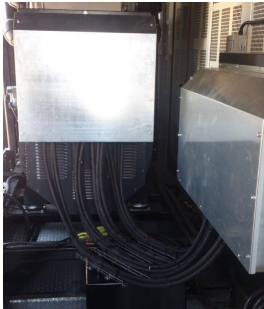
Figura 3.20. Sistema de transmisión de potencia tipo F en grupo electrógeno
