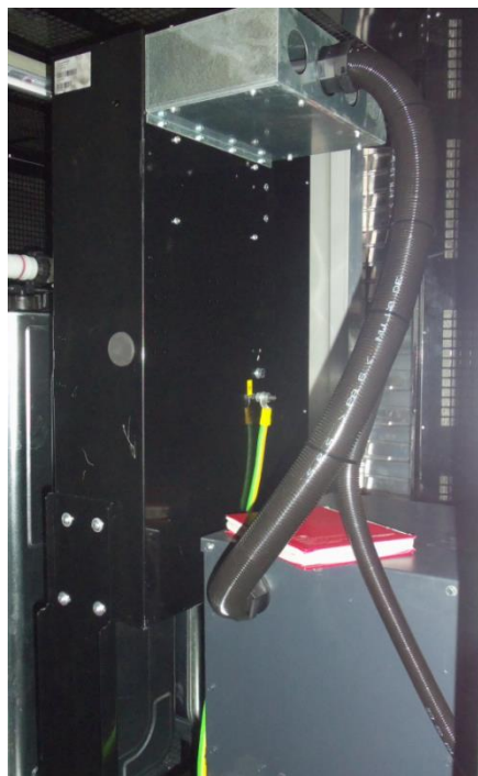
Figura 3.21. Sistema de transmisión de potencia tipo B1 en grupo electrógeno
