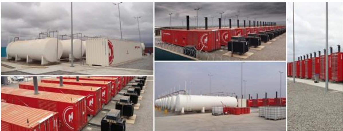
Figura 1.1. Planta industrial de grupos electrógenos
