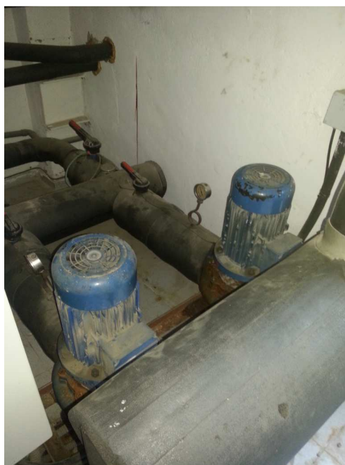
Figura 32. Bombas del circuito secundario. Edificio principal.
