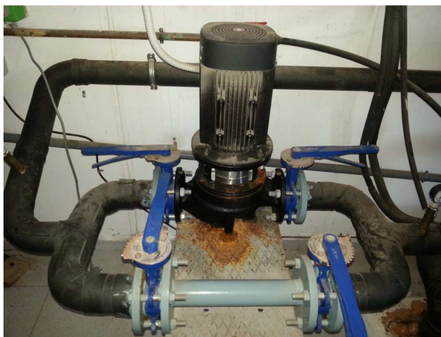
Figura 30. Bomba del circuito secundario. Edificio ala este.
