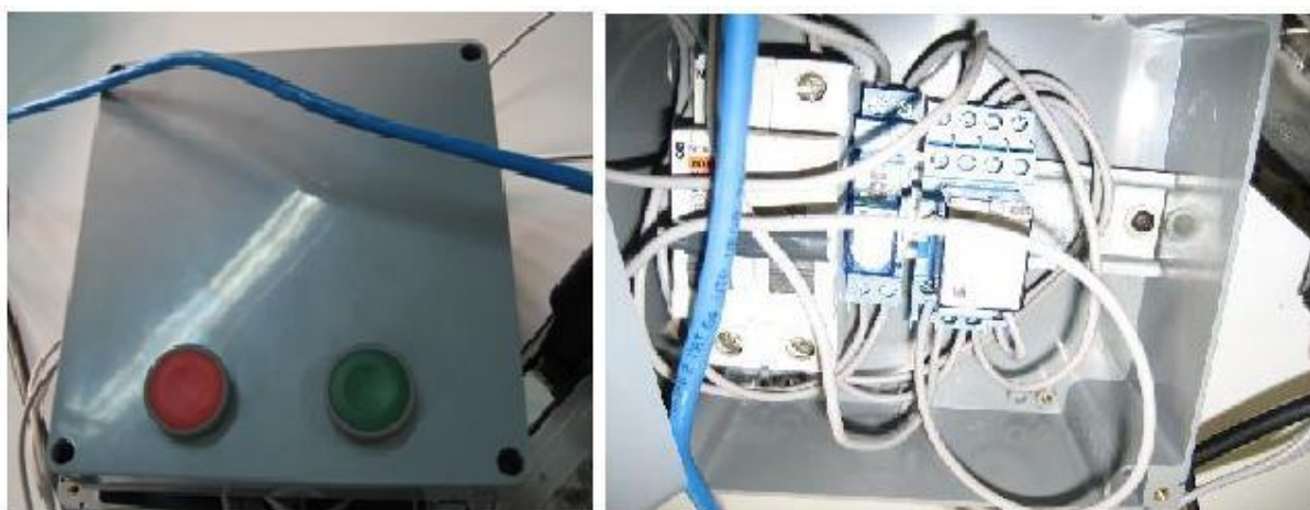
Figura 12. Cuadro eléctrico de control.
