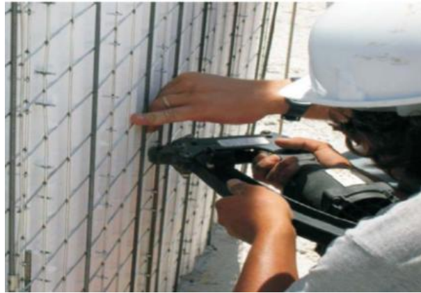
Fotografía 9. Tornillos sin fin más presillas metálicas
