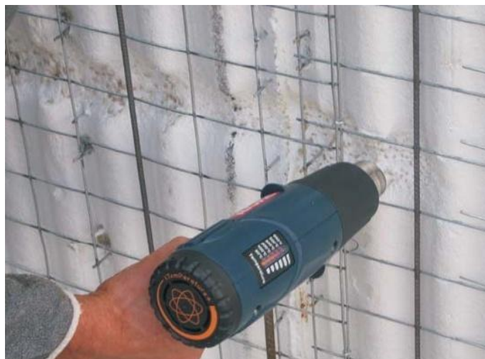
Fotografía 33. Instalaciones en capa panel EPS
