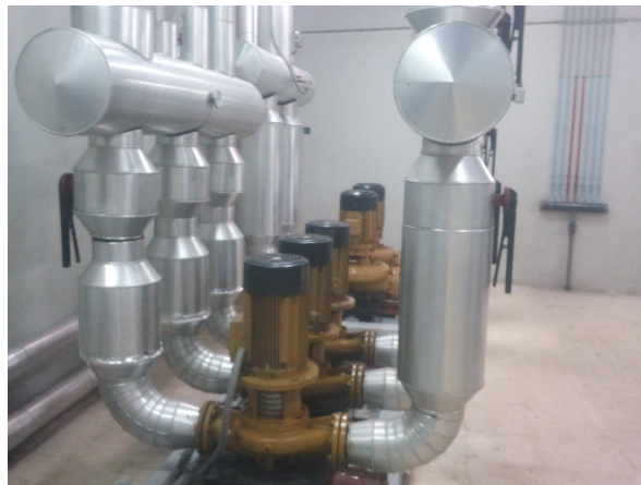
Fig. 16,- Bombas Impulsión y Retorno
