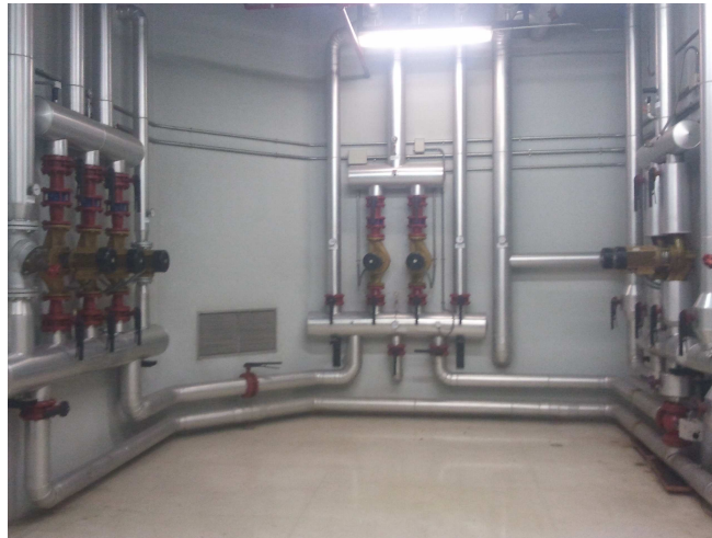
Fig. 17.- Equipos Producción Calor
