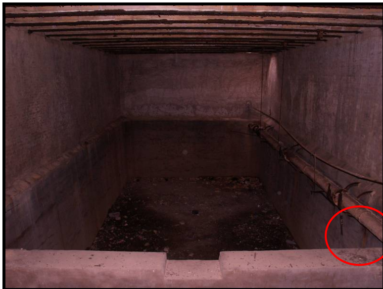
Fotografía general del depósito donde se ve la tinción bajo una tubería oxidada.
