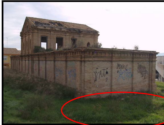
Detalle de humedad en el zócalo.
