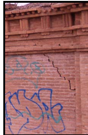
Detalle de la grieta.
