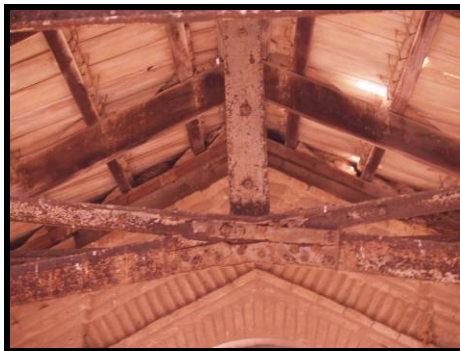
Fotografía de oxido de las cerchas
