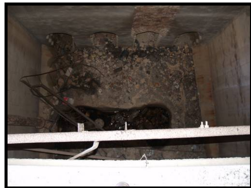
Detalle de humedad
