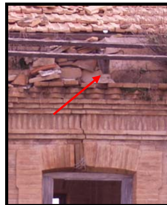
Detalle de la grieta, y el apoyo de cercha
