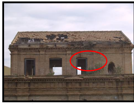
Detalle de humedad 2.
