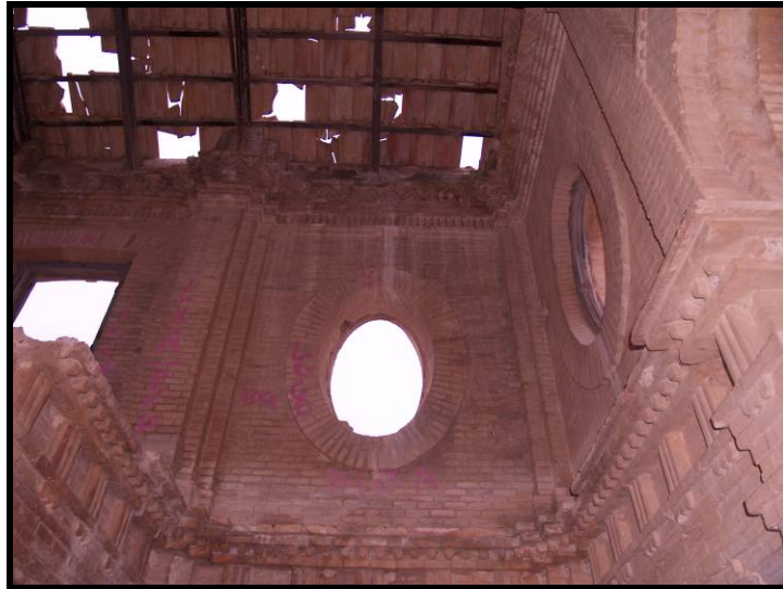
Detalle general de la suciedad de la fachada interior.
