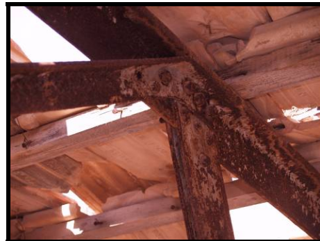
Detalle de oxido en la cercha
