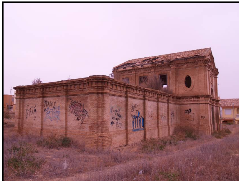
Fotografía general del depósito con los graffitis
