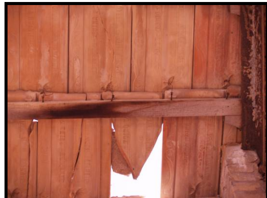
Detalle de tejas fracturadas.
