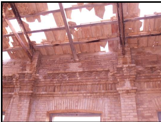
Fotografía de detalles de tejas fracturadas y caídas.
