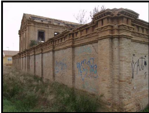
Fotografía del detalle de la grieta
