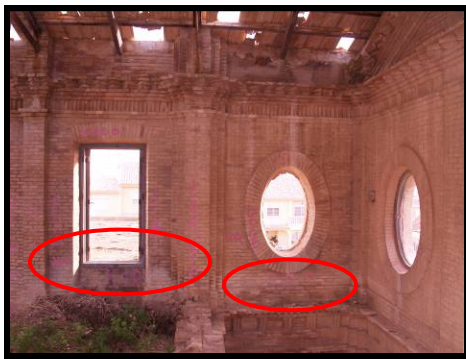
Detalle de humedad 1.
