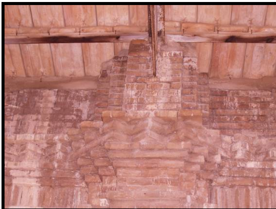
Detalle de suciedad en fachada interior.
