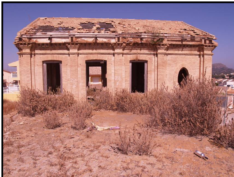
Fotografía general de biodeterioro por plantas.
