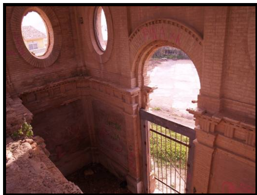
Fotografía de la reja oxidada.
