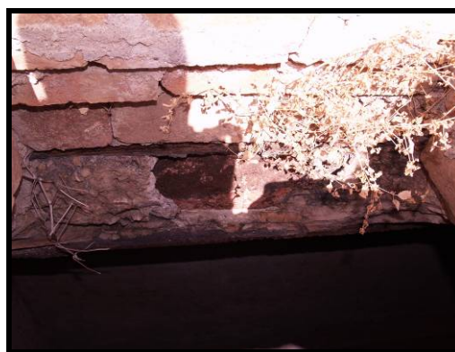
Fotografía de detalle de óxido en la IPN
