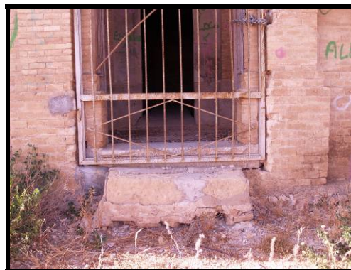
Detalle de óxido en la reja.
