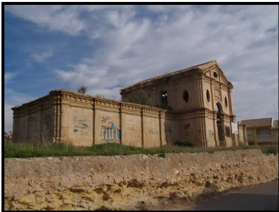
Fotografía de ladrillos fracturados y caídos
