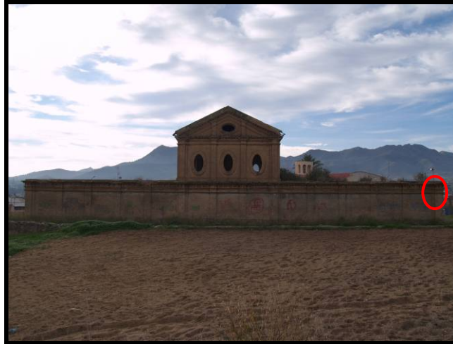
Detalle general de grieta en la fachada trasera.
