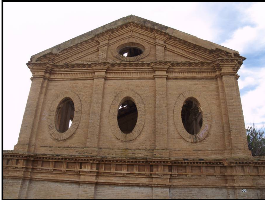
Detalle general de la fachada posterior: biodeterioro
