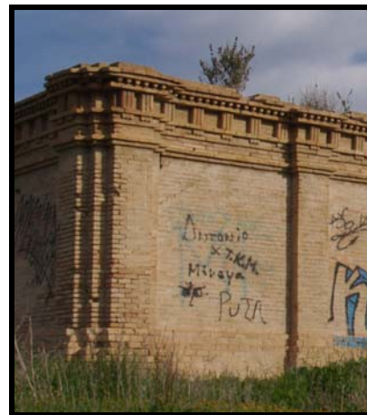
Detalle de ladrillos fracturados y caídos
