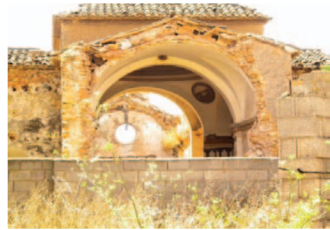
Figura 21. Ermita de San José en el Lentiscar. Detalle del estado de deterioro.
