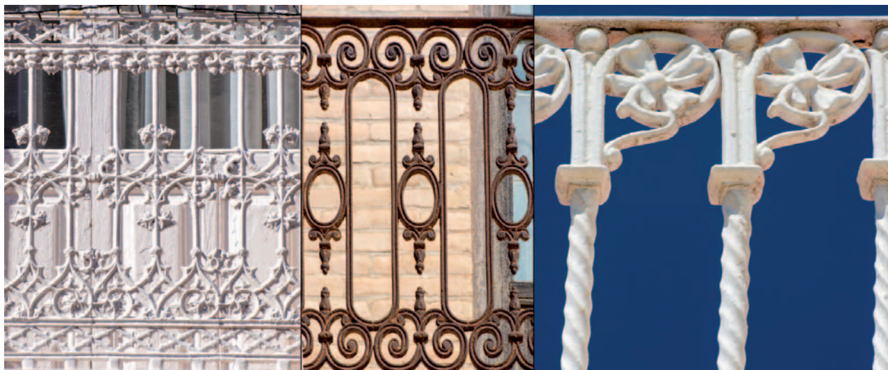
Fotografía 22. Barandillas realizadas con piezas de fundición. Izquierda, vivienda en la calle Mayor de Torre Pacheco. Centro, barandilla de Villa Antonia, en la diputación de Pozo Estrecho, y derecha Finca Casablanca, en la diputación de El Plan. (Fotografías del autor).
