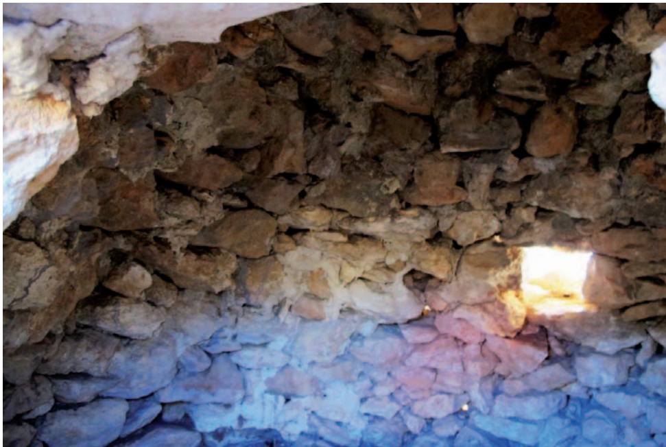
Figura 4. Detalle del interior de una cámara con orificio de ventilación al fondo.
