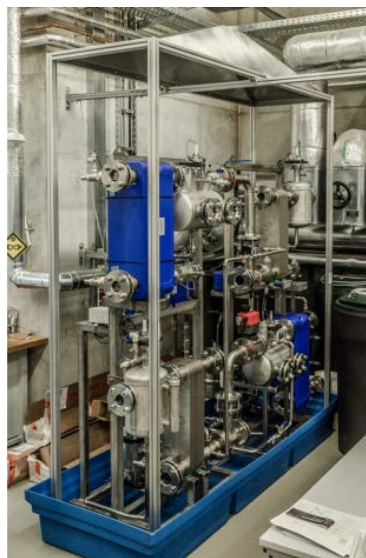
Figura 4. Planta de refrigeración por absorción-resorción de 25kW (TU Dresden).
