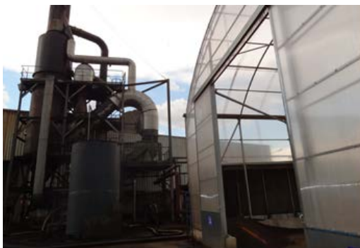
Figura1. Emplazamiento junto a la torre de concentración.
