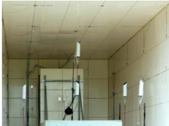
Figura 2: HFS Tiles en una de las celdas Paslink del LCCE.
