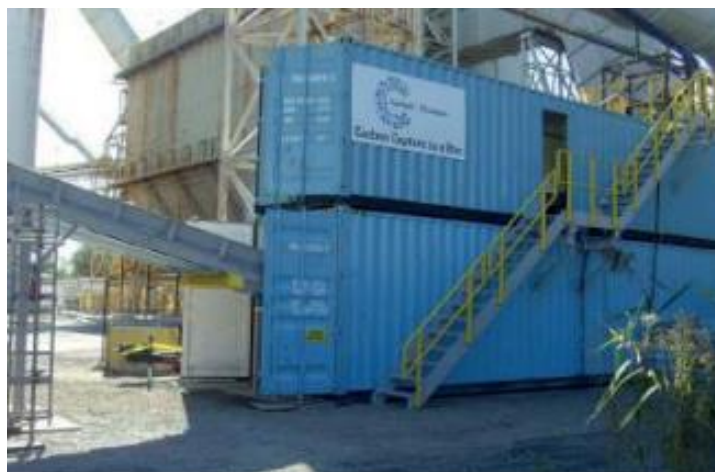
Figura 4.6.1: Contenedor de \text{CO}_2 en una planta de cemento [67].
