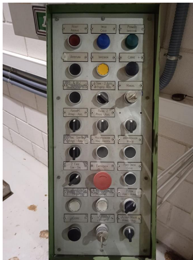
Figura 3.6 Panel de controles de la máquina
