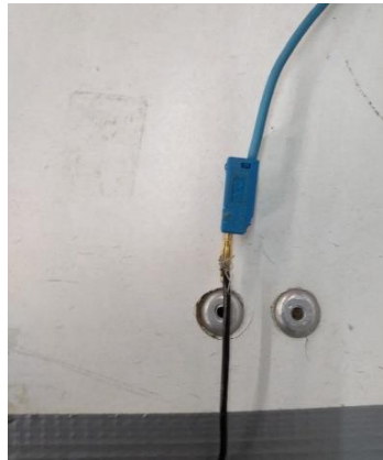
Ilustración 33. Cable a tierra
