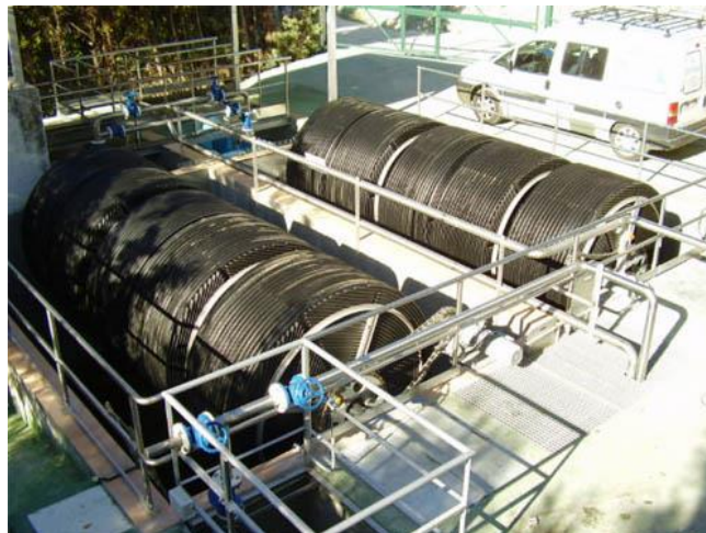
Figura 4.4 Planta de tratamiento de aguas residuales mediante biodiscos
