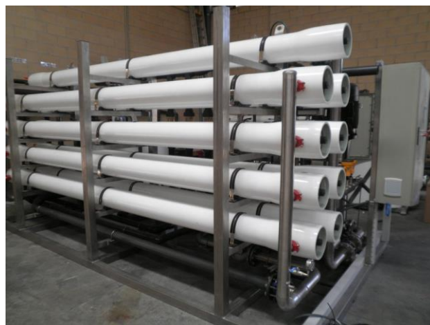
Figura 4.16 Planta de ósmosis inversa.
