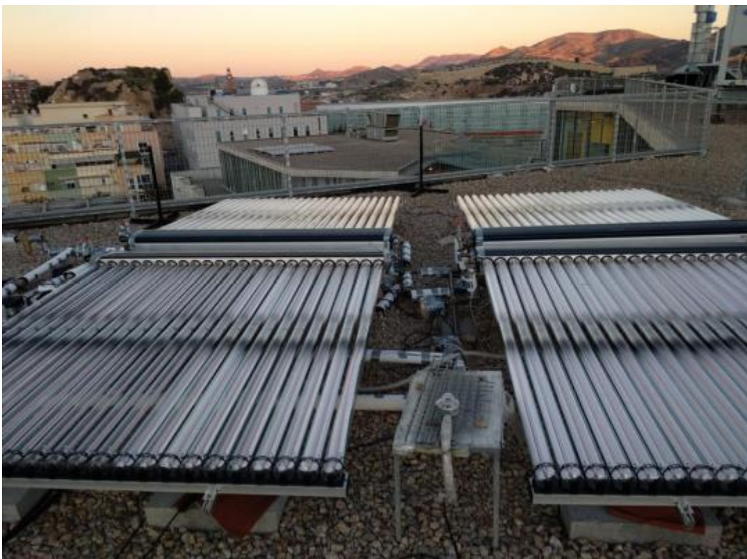
Figura 6. Tubos de vacío y piranómetro de la instalación.
