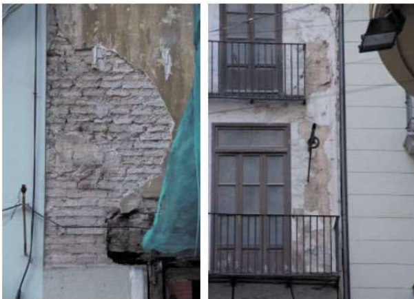
Figura 6. Detalle del desprendimiento del revestimiento (izquierda) y del abolsamiento superficial del revestimiento (derecha) en dos edificios históricos de Valencia (V. La Spina)
