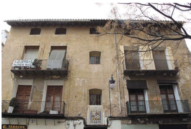
Figura 1. Edificio histórico que aún conservaba su revestimiento histórico a finales de 2014 y que hoy en día ha sido sustituido (V. La Spina)
