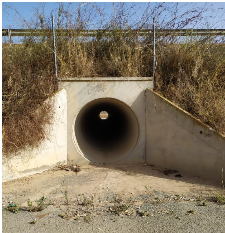
Figura 82. Tubo de 1000 mm. Situado en P.K.788+100.
