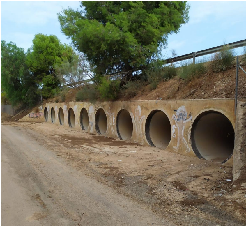
Figura 84. Conjunto de 9 tubos 1800 mm. Situado en P.K.789+600.
