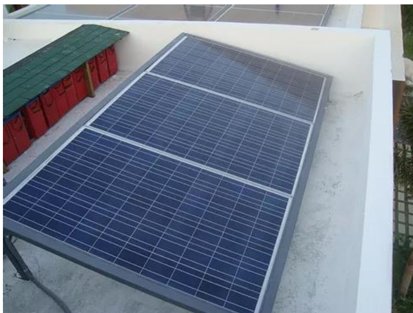
Ilustración 9. Instalación fotovoltaica Cap. Cana. Fuente:Grupo Arroyo. [14]
