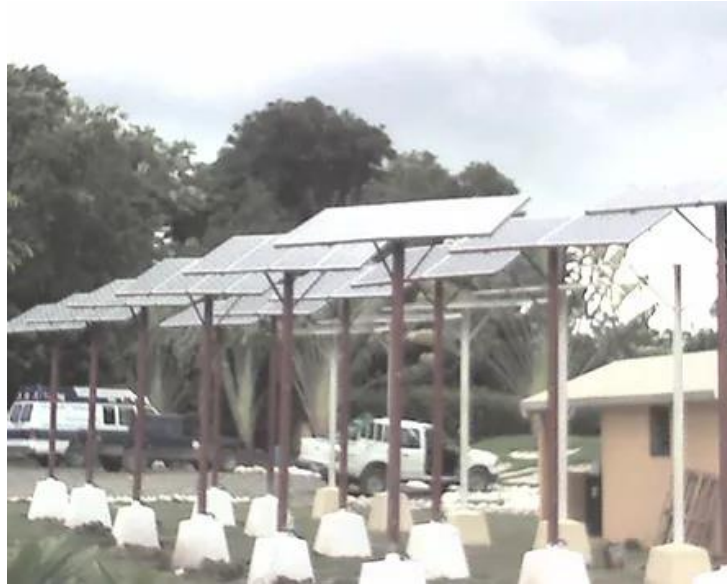
Ilustración 6. Instalación fotovoltaica, IDDI Bonao. Fuente: Grupo Arroyo. [14]
