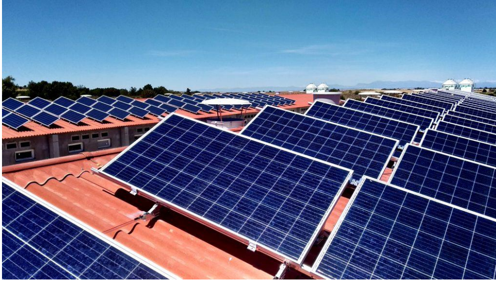
Ilustración 1 Paneles fotovoltaicos instalados en granja porcina de Arangón [1] .
