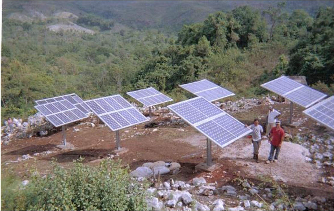
Ilustración 8. Bombeo solar Inapa. Fuente:Grupo Arroyo. [14]
