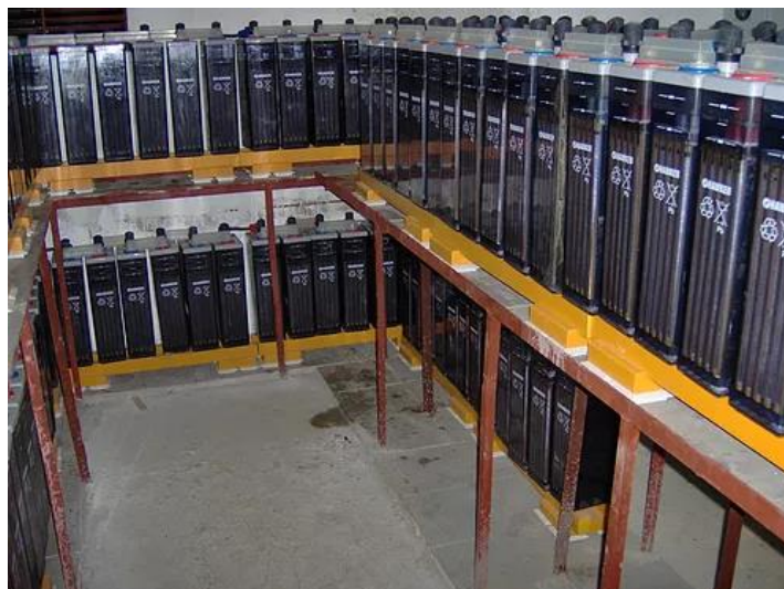
Ilustración 7. Sistema de acumulación de instalación fotovoltaica en Jarabacoa. Fuente: Grupo Arroyo. [14]
