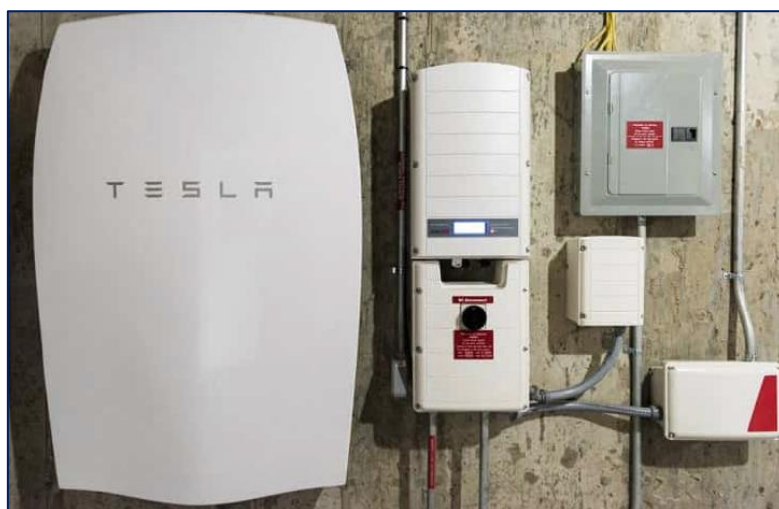
Fig. 4.1.1. Sistema de baterías PowerWall (Tesla)
