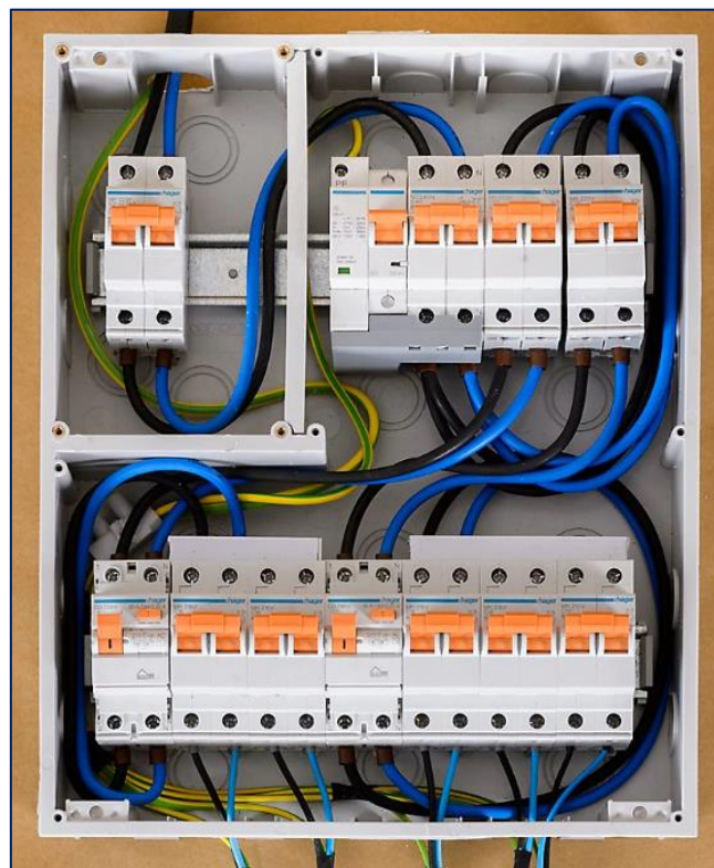
Fig. 5.2.4. Cuadro de protecciones con cableado.
