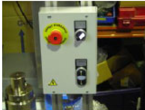
Fig. 3.7 Panel de control manual, con botón de parada de emergencia.
