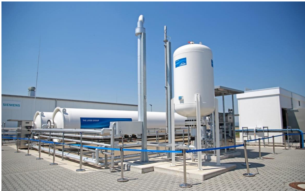
Imagen 3. Instalaciones de Energy Park Mainz, Alemania.
