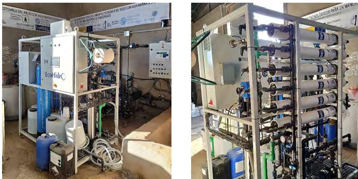
Figura 1. Equipo de reducción de boro en el agua de riego basado en la implementación de membranas de osmosis inversa (izquierda: parte frontal;
