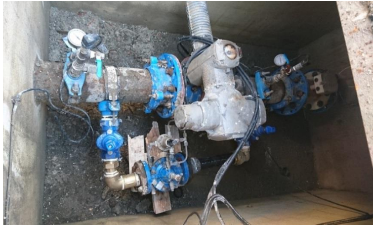
Figura 2.12: Válvula reductora de San José Obrero Sur.
