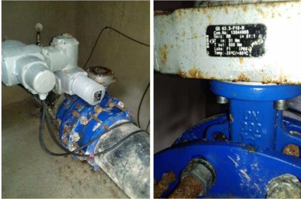
Figura 2.15: Válvula reductora de entrada al Casco Urbano.
