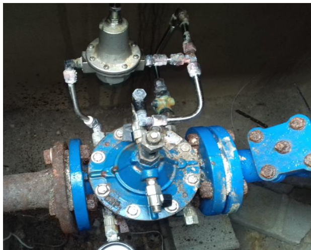
Figura 2.13: Válvula reductora de San José Obrero Norte.
