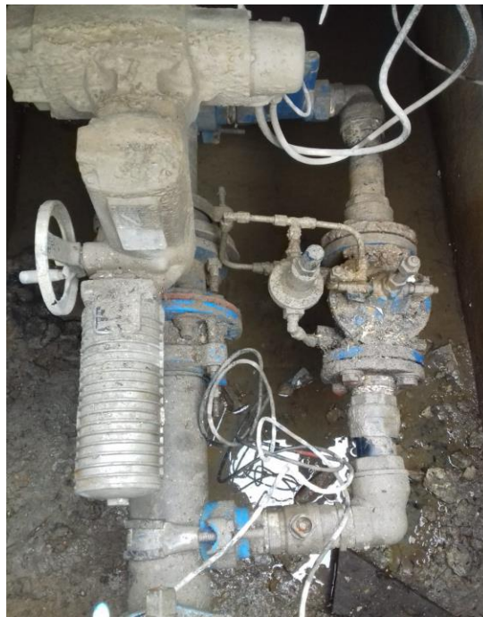
Figura 2.11: Válvula reductora de Sanz Orrio.
