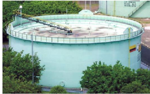
Figura 10. Tanque cilíndrico vertical de techo flotante
