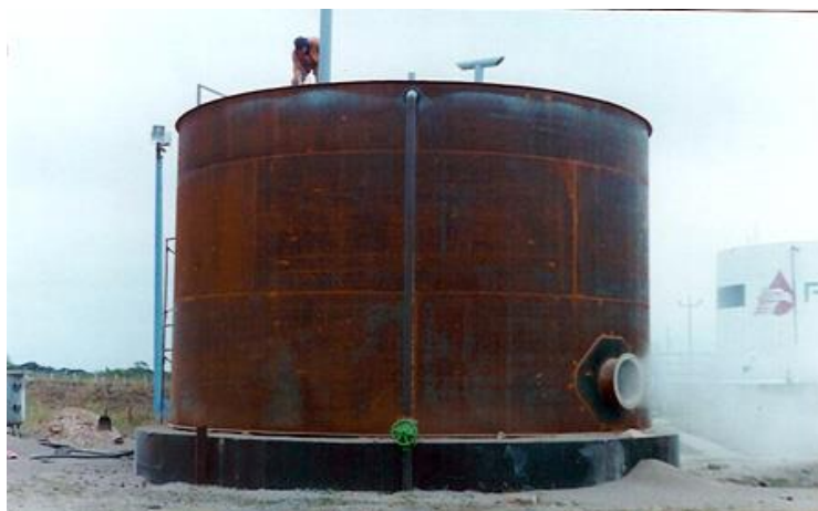
Figura 23. Tanque industrial afectado por la corrosión
