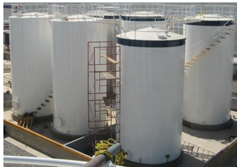
Figura 9. Tanque cilíndrico vertical de techo fijo
