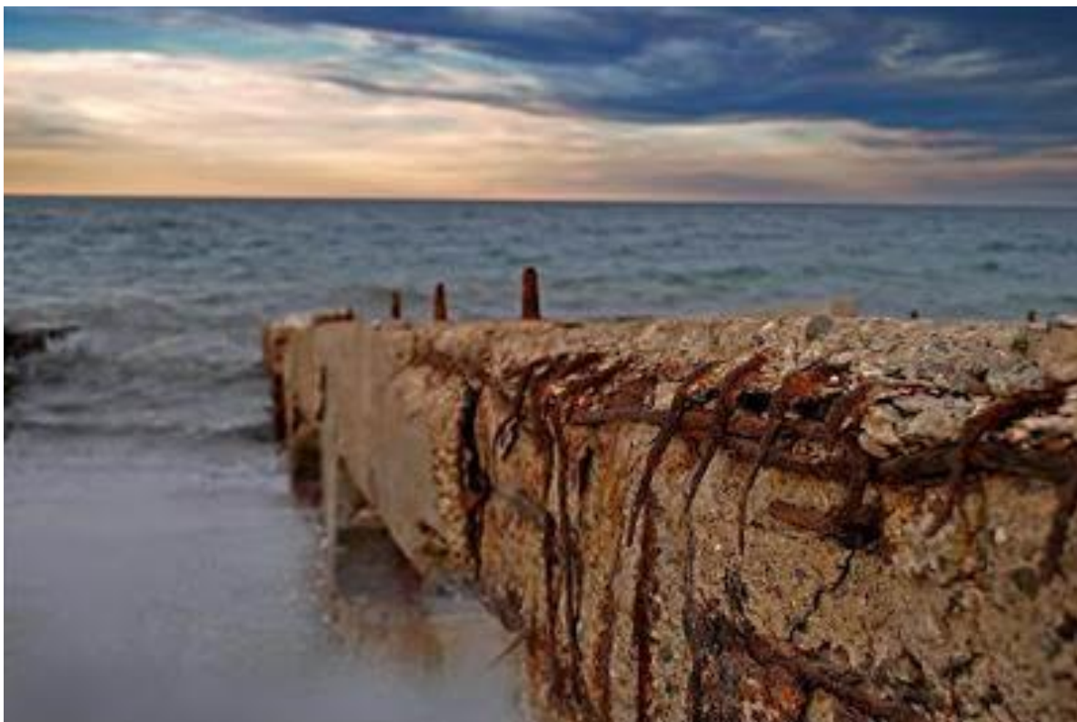
Figura 2.5.1 Efectos provocados por ambientes marinos en el hormigón. (Blog hidrodemolición, 2017)
