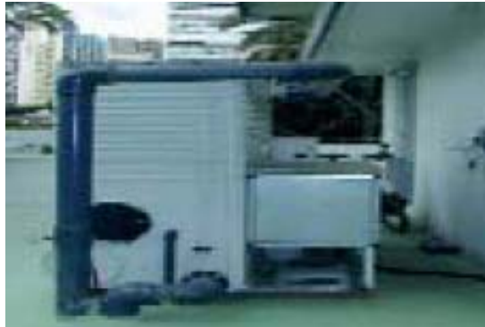
Fotografía XI. Torre de refrigeración en el Hotel Belroy Palace.
