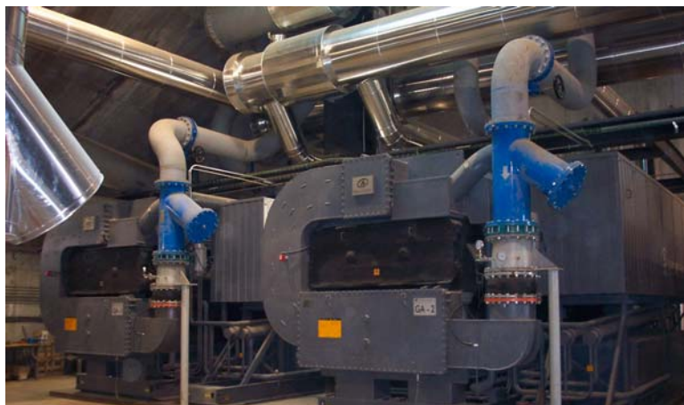
Fotografía XII. Máquinas de absorción. Instalación Forum Barcelona.
