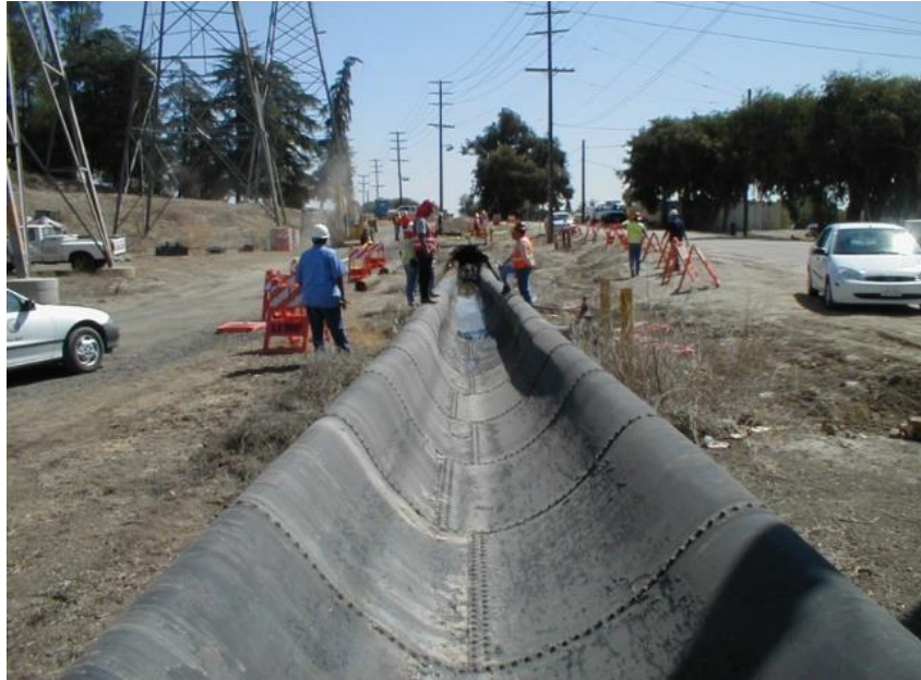
Figura 3 - Colapso de una tubería provocado por la depresión sufrida en un Golpe de Ariete
